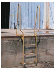
W4 Permanent Dock Ladder
